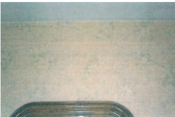
Fissuration intérieure, tapisserie déchirée - Maison André.
